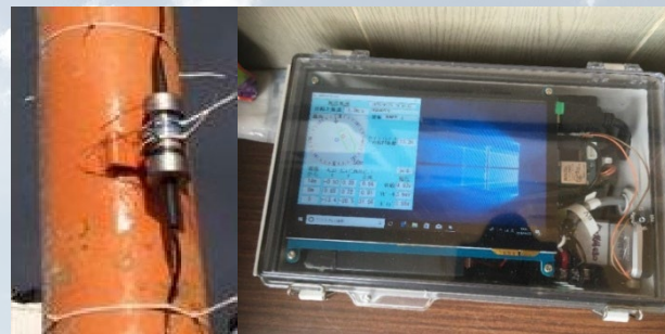
傾斜管理システム
