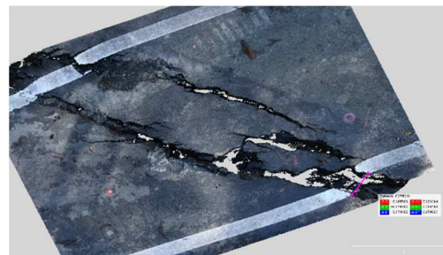
道路変状箇所の三次元画像化例
