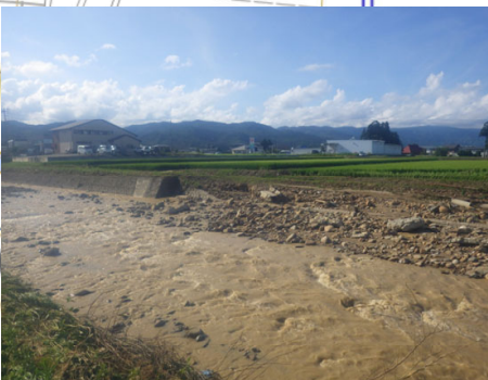
P5 萩生川左岸側越流箇所
