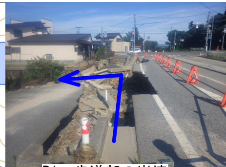
P1 歩道部の崩壊
