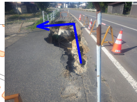
P5 山形県道10号長井飯豊線 歩道部の崩壊
