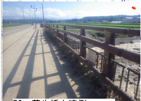
P2 萩生橋上流側 (越流した痕跡有り)
