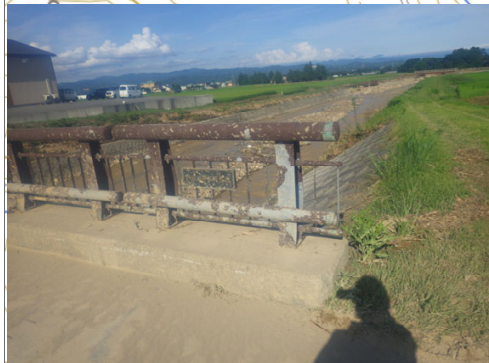
P3 萩生橋下流側 (越流した痕跡有り)
