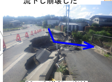
P3 歩道部の崩壊
