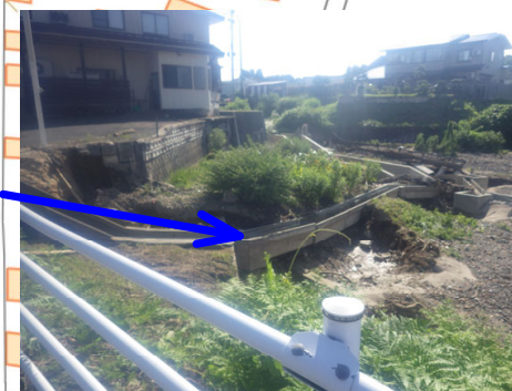
P7 縦断排水が→の方向に 流下し崩壊した
