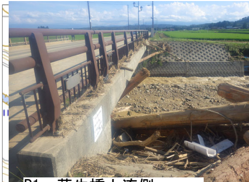
P1 萩生橋上流側 (越流した痕跡有り)
