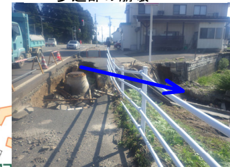
羽前橋 P6 歩道部の崩壊
