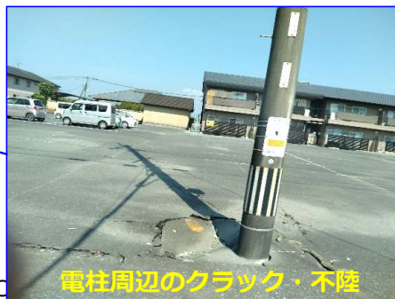
歩道のクラック、店舗との段差
