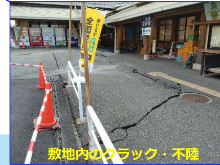
敷地内のクラック・不陸
