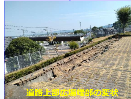
竜北公園方向のクラック
