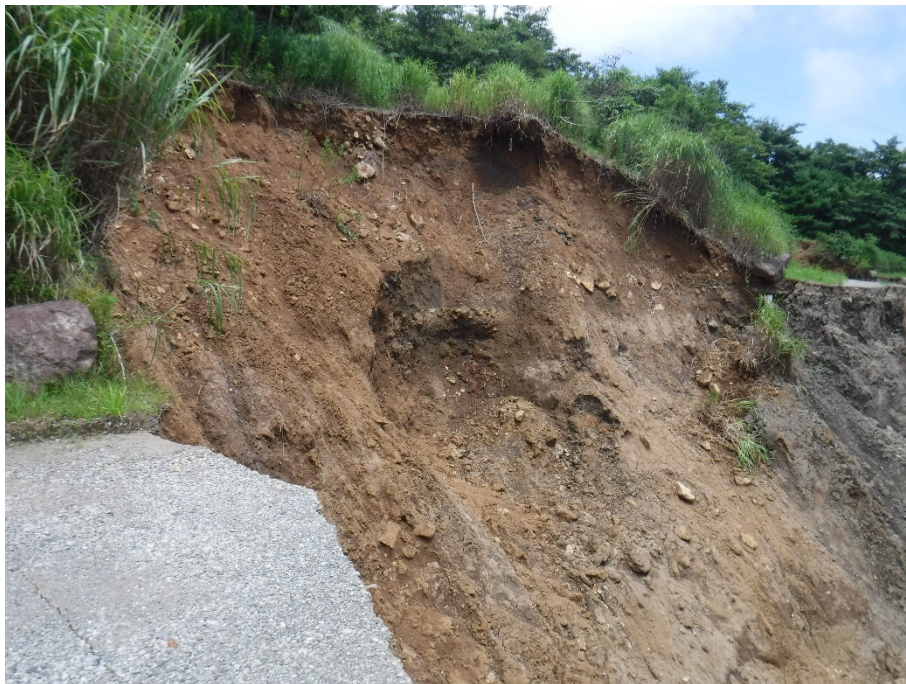
地山の崩壊箇所
