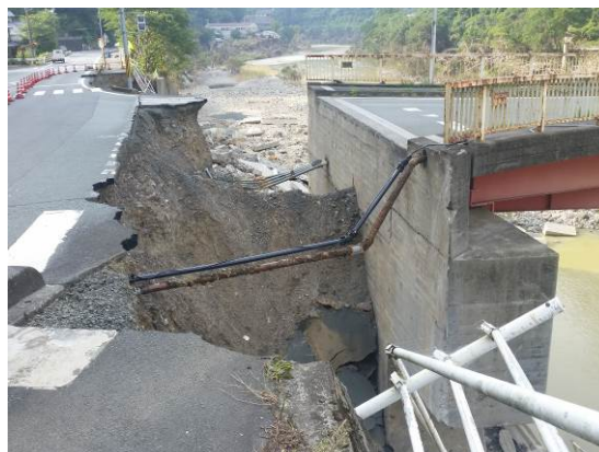
橋台裏込めの洗掘
