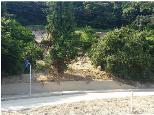
道路脇緩斜面の表層崩壊
