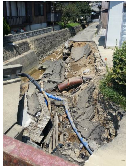
国道 387 号，県道 271 号の交差点やや西の小 河川。護岸部の浸食と橋の破壊。 仮橋が施工されている。
