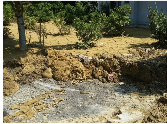
庭に流れ込んだ崩壊①②の土砂。 茶褐色のシルト～砂で細粒。
