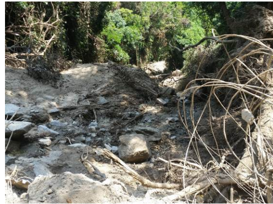
林道を横切る谷の土石流跡 (林道下流側を撮影)
