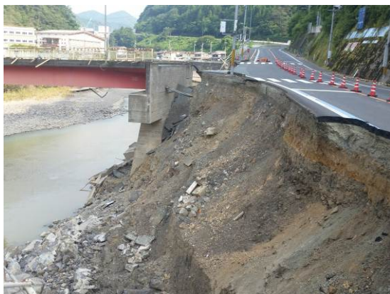
道路と橋台部の洗掘
