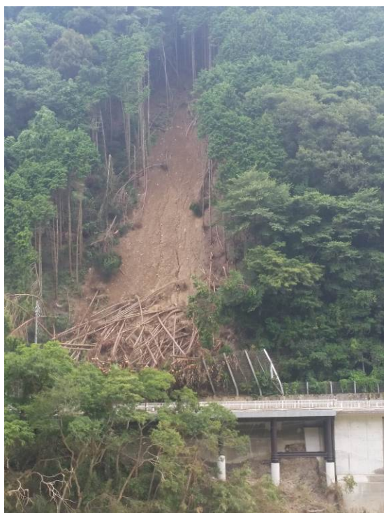
軽量盛土の浮き上がり箇所 の下流側の崩壊地
