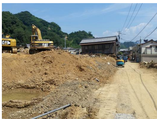
崩壊土砂（道路の土砂は撤去済み）
