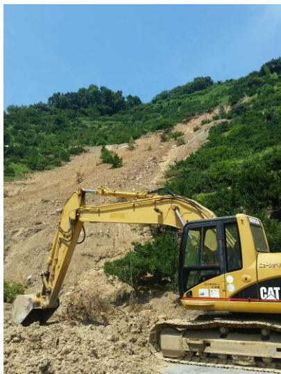
国道 378 号の斜面崩壊
