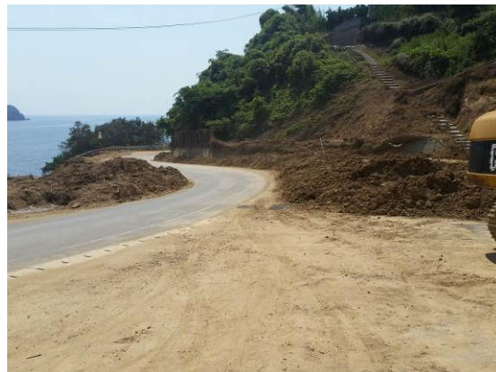
国道の土石は撤去済み
