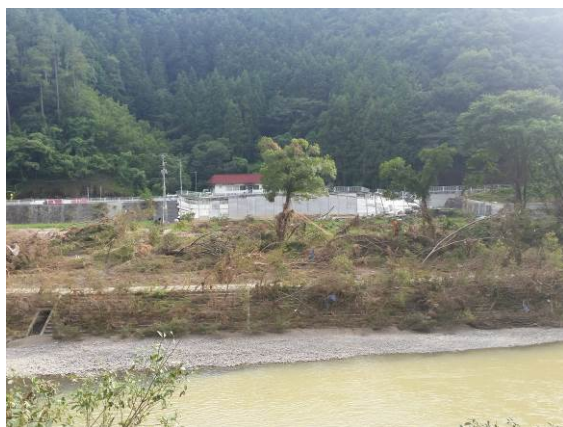
軽量盛土の浮き上がり箇所
