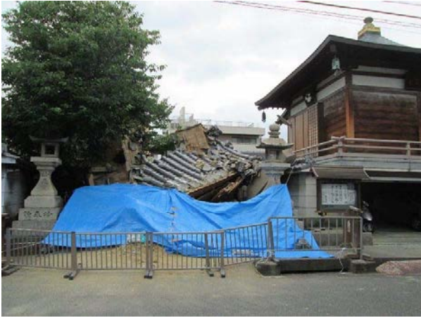
I-01_01 妙徳寺 屋根の崩壊(右が北)
