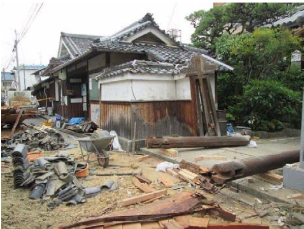
I-02_01 浄教寺 崩壊状況(右が北)
