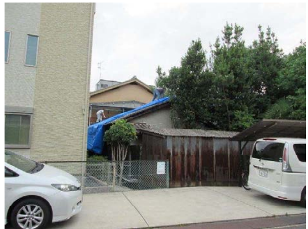
I-04_04 片桐町 屋根瓦の崩壊（手前側が東）
