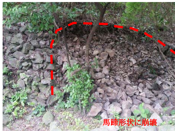
TN-01_02 南平台(避難勧告地域) 石積みの崩落(TN-01_1 の拡大)
