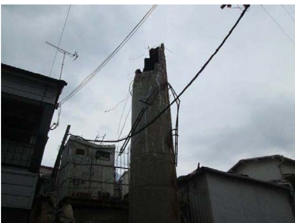
H-02_02 平和温泉 煙突の崩壊(拡大)
