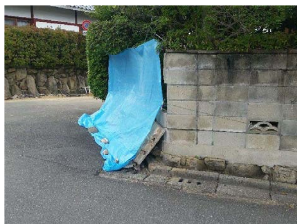
TN-03_02 南平台(避難勧告地域) ブロック塀の倒壊(TN-03_1 拡大)
