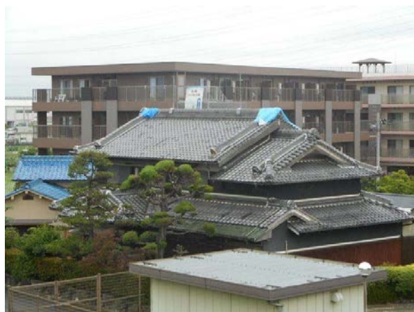
TS-04 前島 屋根瓦の落下
