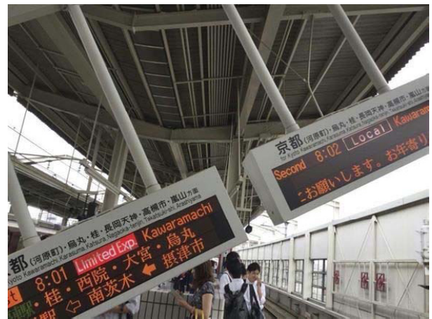
I-06_02 茨木市駅 電光掲示板落下 (HP より)
