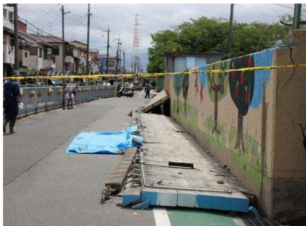
TS-01 川添 小学校ブロック塀の倒壊(HP より)
