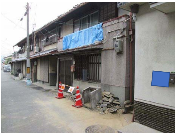
I-03_01 上泉町 屋根瓦の崩壊（右が東）
