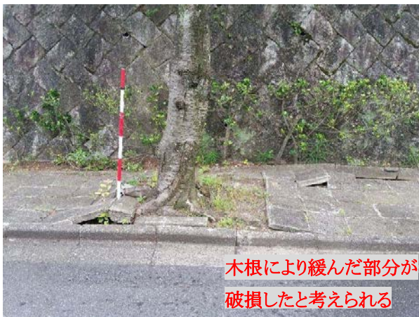
TN-07 安満御所 歩道舗装ブロック破損
