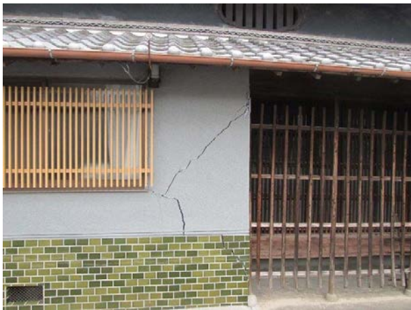
I-03_03 上泉町 民家のクラック
