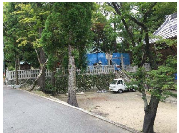
TN-06 大字原 神社屋根破損
