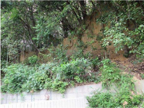
H-01_01 香里園(避難勧告地域) 落石、木の崩落の可能性あり(右が東)
