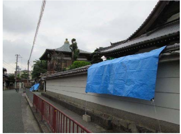
I-01_02 妙徳寺 屋根瓦の崩壊
