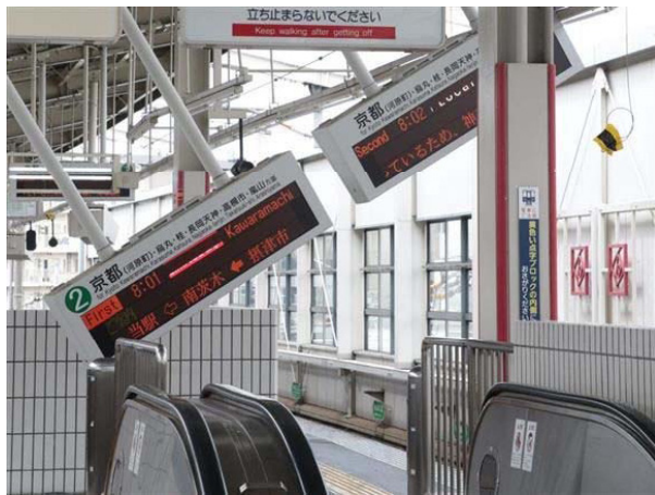
I-06_01 茨木市駅 電光掲示板落下 (HP より)
