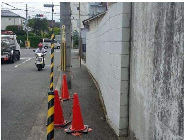
TN-05 宮野川原 高さ約 2m の小学校ブロック塀 カラーコーンによる危険の明示済
