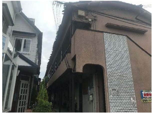
I-04_02 片桐町 屋根瓦の崩壊（建物手前側が東）
