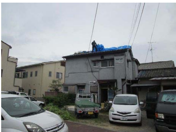
I-03_05 上泉町 屋根瓦の崩壊（右が東）
