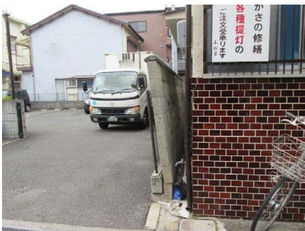
I-05_01 宮元町 ブロック塀の傾斜（手前側が東）
