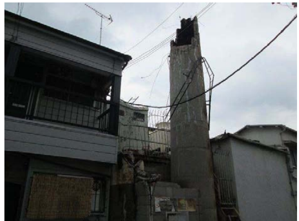
H-02_01 平和温泉 煙突の崩壊
