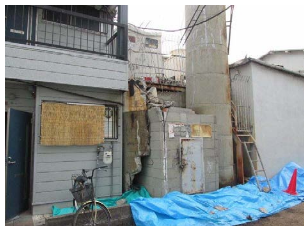
H-02_03 平和温泉 煙突落下状況
