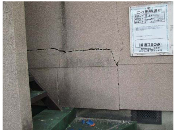
I-03_04 上泉町 アパートのクラック
