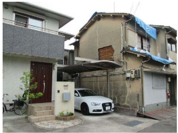
I-03_02 上泉町 屋根瓦の崩壊
