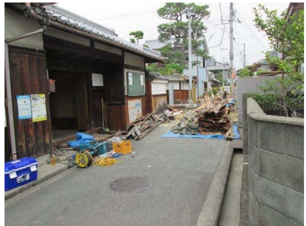
I-02_02 浄教寺 崩壊状況
