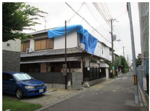
I-03_06 上泉町 屋根瓦の崩壊（奥が東）
