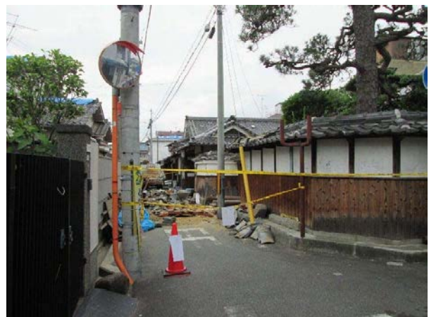
I-02_04 浄教寺 崩壊状況
