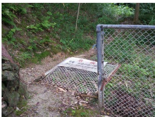
N-01_03 南平台(避難勧告地域) 隣接するフェンス、地震により倒れた可能性あり
