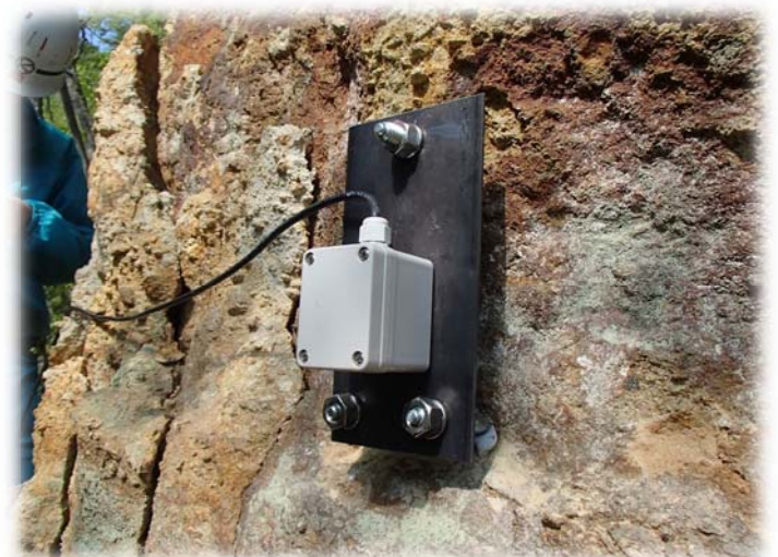
感太郎設置状況(アンカーボルトにて直接固定)
