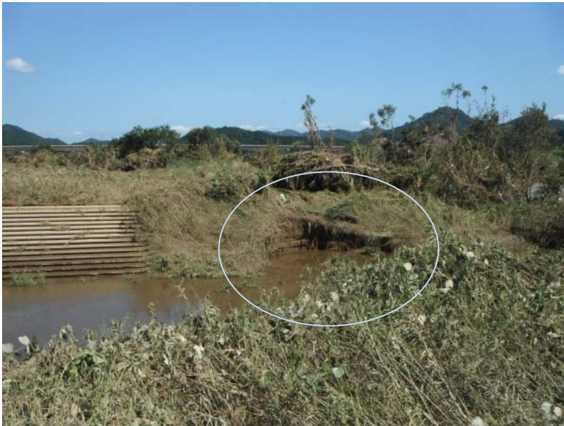
写真-11 水門付近 浸食跡
