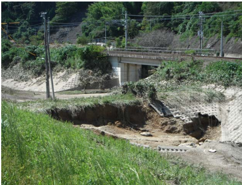
写真－ 9 洪水による盛土破壊
