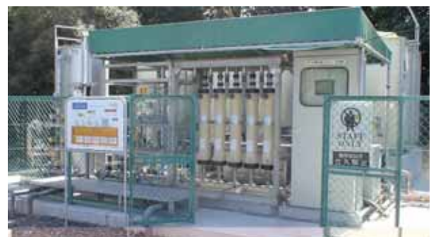
写真 11.1 膜ろ過を用いた地下水浄化設備の例
